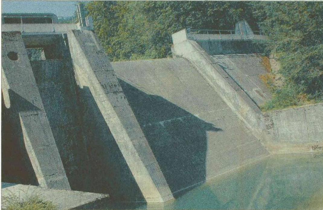
L'eau a été moins abondante que d'habitude dans le barrage sur l'Aubonne. Conséquence: la SEFA a davantage acheté d'électricité à Romande Energie. ARCHIVE STÉPHANIE TRIBET
